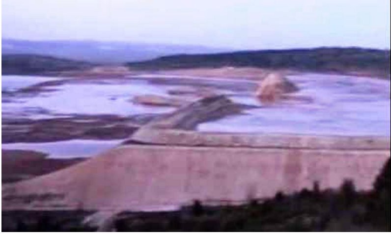
Ekil 23. Yıkılan ara setlerin görünümü
