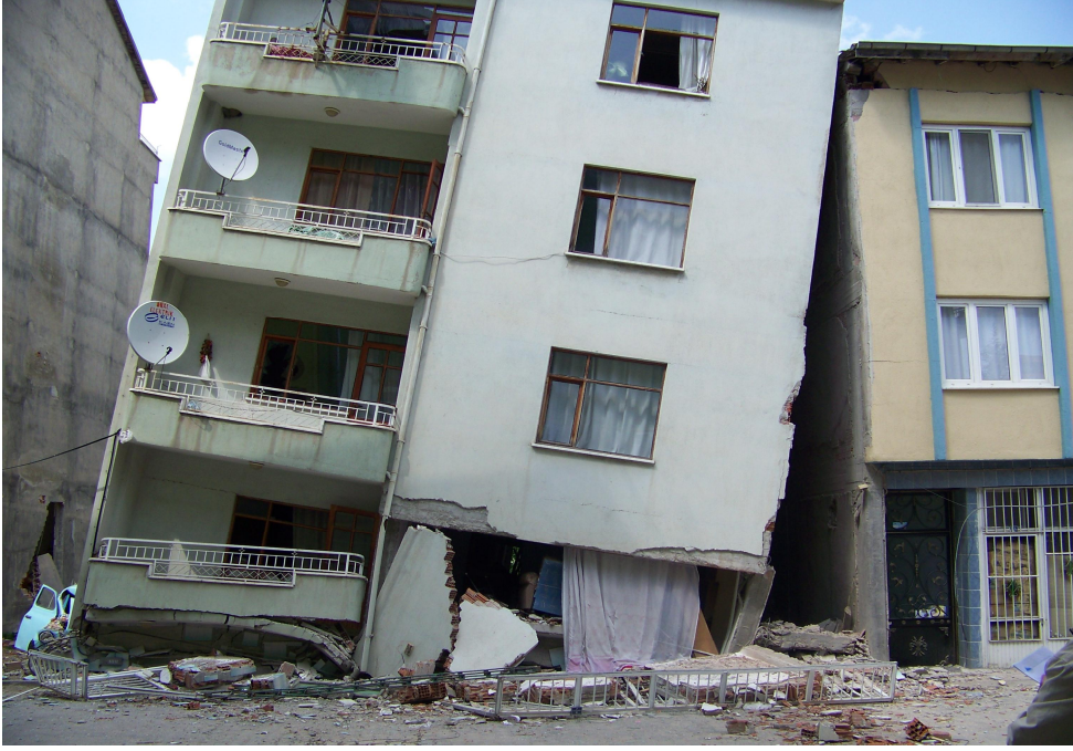
ekil 9. Aşırı hasarlı bir binadan görünüm
