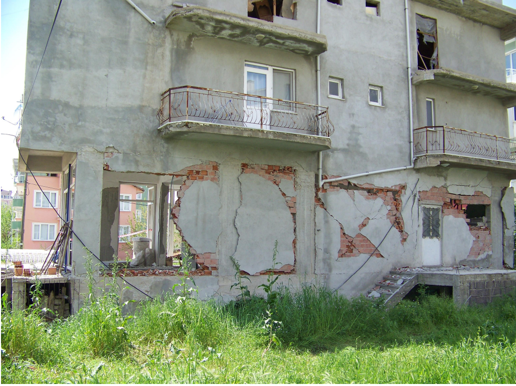
ekil 11 A ,r hasarlı, binalardan görünüm
