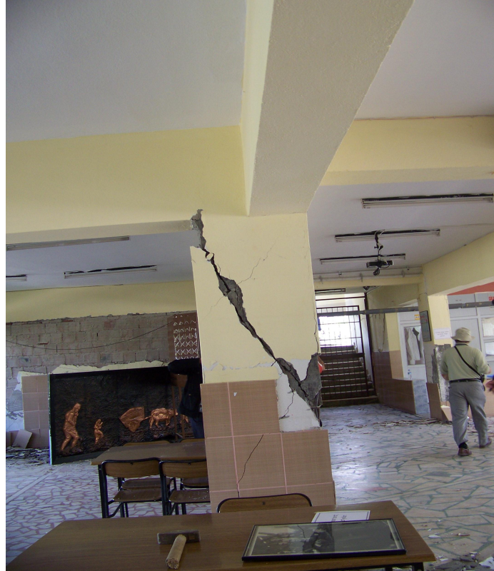
ekil 8. Nurullah Koyuncu Anadolu Lisesindeki kolon çatlakları,
