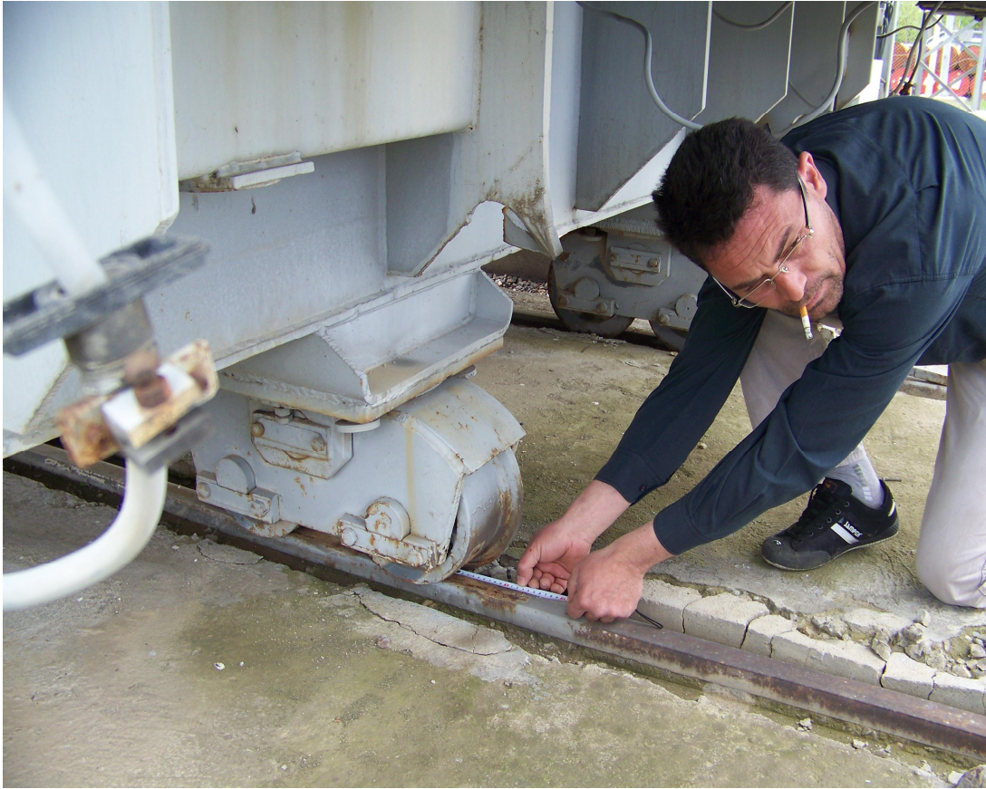
ekil 14. Trafo Merkezinin Yağ tankları,ın Ray Üzerindeki Hareketi.
