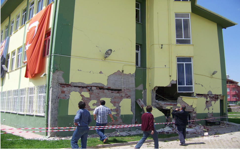
ekil 7. Nurullah Koyuncu Anadolu Lisesinin hasarlı bölgesinin genel görünümü.
