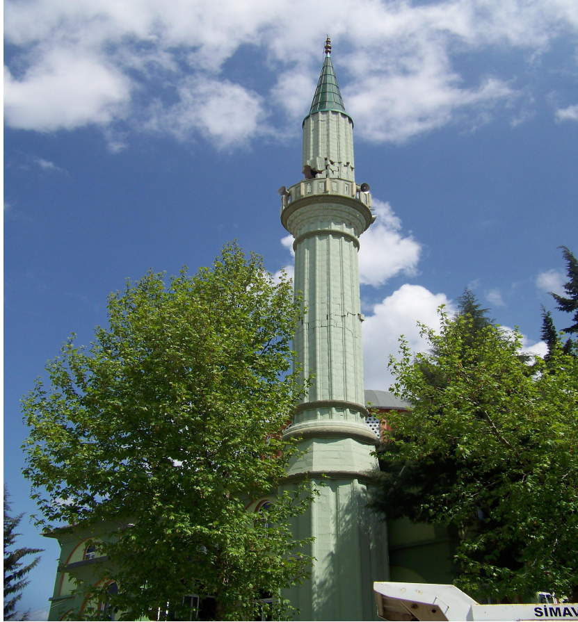
ekil 12. Merkez Garaj Camii'nde Minarede Kesme Çatla ,
