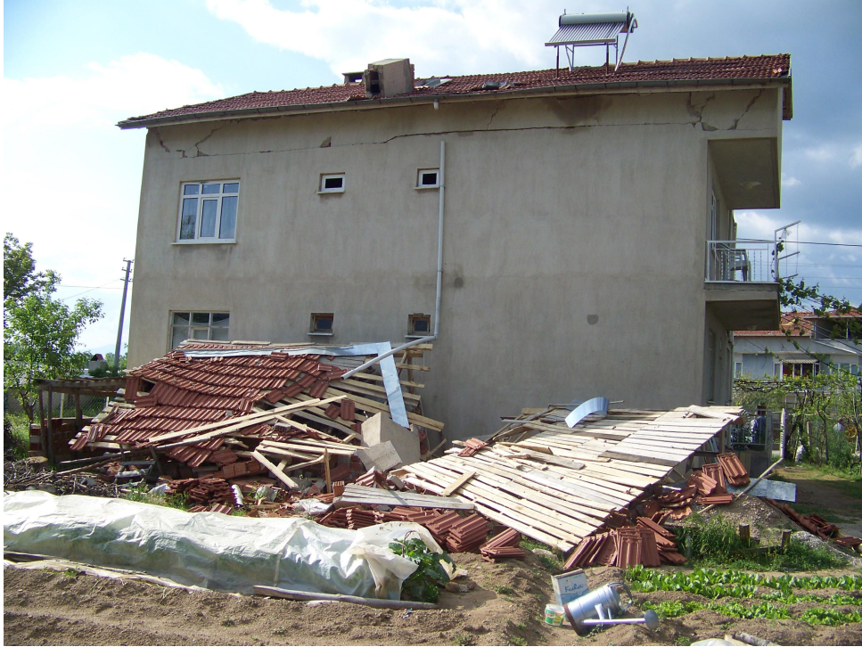
ekil 19. Sundurmada y,k,лма ve betonarme yap,daki hasarlar
