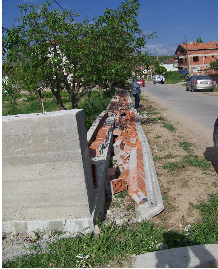
ekil 18. Bahçe duvarlar,nda meydana gelmi devrilme ve y,k,lmalar
