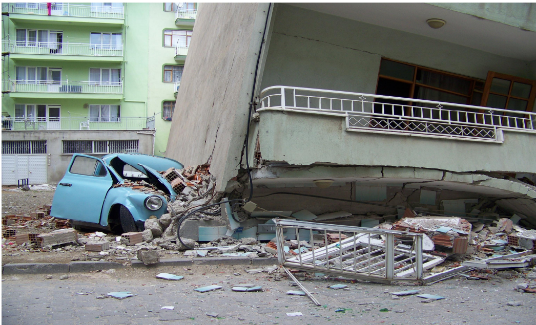
ekil 10. Aşırı hasarlı binadan görünüm
