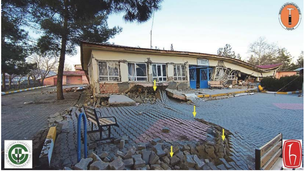
Yunus Emre Ortaokulu önünde yüzey yırtılmasının neden olduğu hasar.
