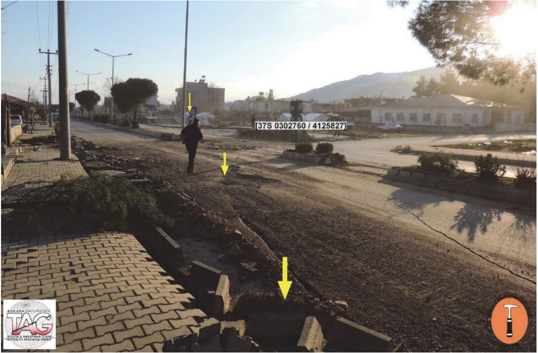
Şekeroba merkezde Belediye Caddesinde yüzey yırtılması.
