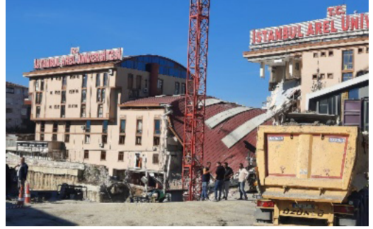
Fotoğraf 77: Arel Üniversitesi Binasında Meydana Gelen Yıkım Basın Açıklaması
