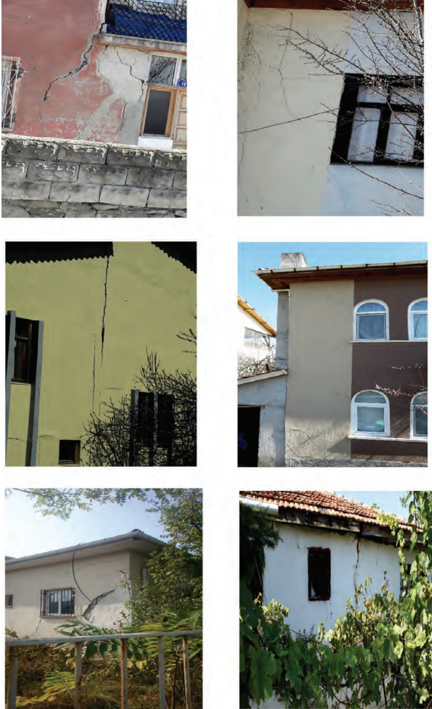
Şekil 1. Gündül yerleşim alanındaki binalarda izlenen çatlak oluşumları.
