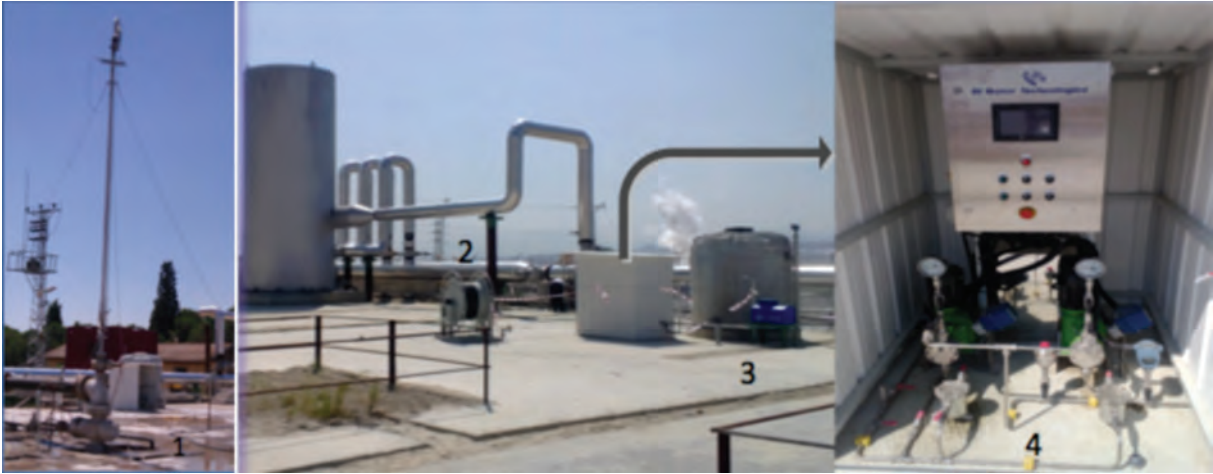
Şekil 6. Kızıldere-II Jeotermal Santralinde kabuklaşmayı engellemeye yönelik kurulan inhibitör sistemine örnek: 1: Lubrikatör Sistemi, 2. Makara Sistemi, 3. İnhibitör Tankı, 4. İnhibitör Pompa ve Kontrol Sistemi (Fotoğraf: Kızıldere-II Jeotermal Santrali)
