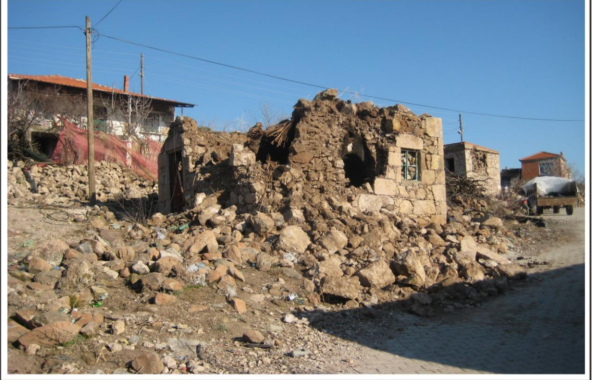
Şekil 9. Yukarıköy'de bulunan yığma binalarda gözlenen hasarlar.
