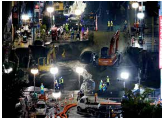
Çökme sonucu gelişen delik yoğun çalışmayla birkaç içinde onarılarak trafiğe açıldı
