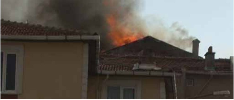
Yıldırım düşmesi sonucu yanan çatının görüntüsü
