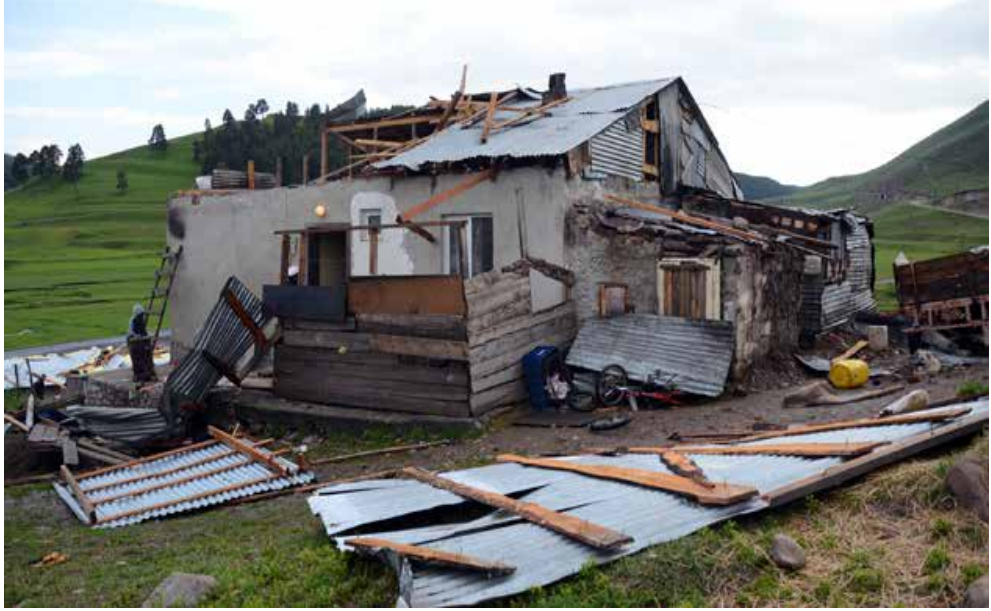
Hortumun etkisiyle zarar gören tek katlı yapının çatısı ve ahşaptan oluşan kısımları ciddi şekilde zarar gördü
