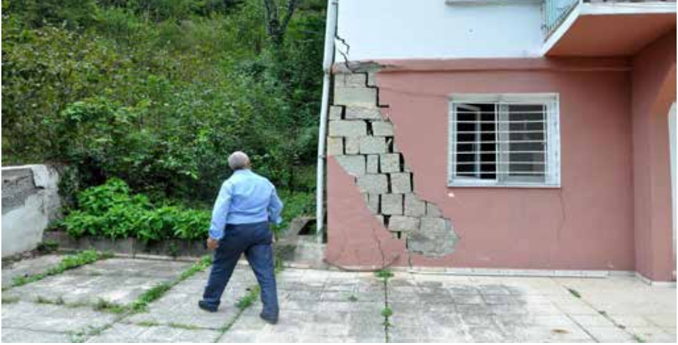
Yerin hareketi nedeniyle yapılarda meydana gelen çatlaklara bir örnek
