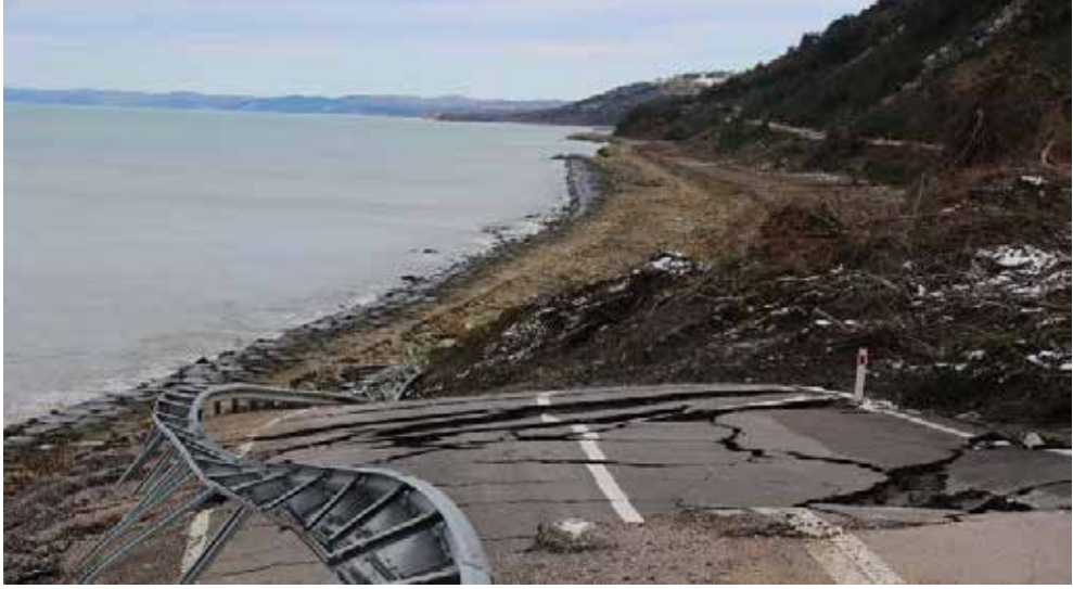
Heyelan ve göçme nedeniyle bozulan Ayancık karayolundan bir görüntü
