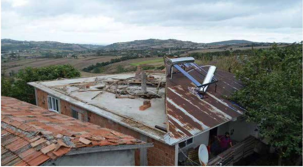
Çatısı uçan evin görüntüsü
