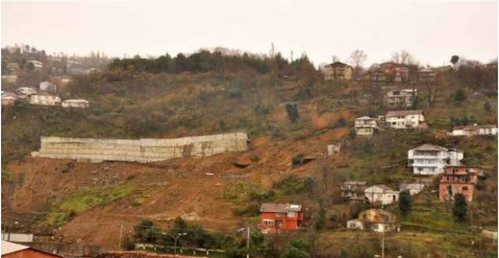
Yanlış kazı nedeniyle yıkılan istinat duvarı heyelanla çöktü ve etrafındaki 11 ev boşaltıldı
