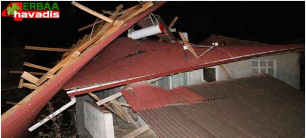
Hortumdan sonra hasar gören evin durumu
