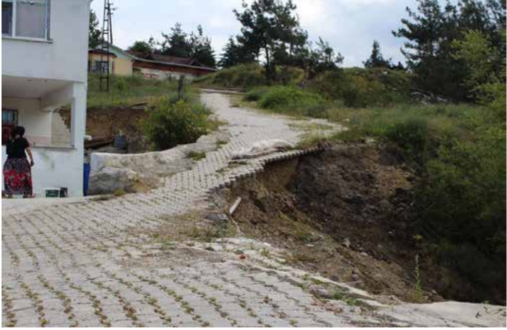
Yerleşim alanındaki heyelan tehlikesi halkın korkmasına neden oluyor
