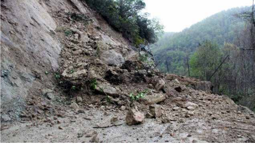
Heyelan sonucu yola dökülen kaya ve toprak malzemesi
