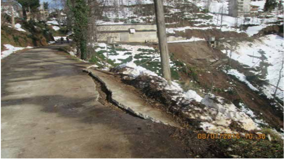
Heyelanın taç bölgesindeki gerilme çatlakları
