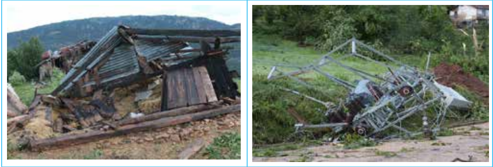
Hortumdan zarar gören ev ve elektrik direği
