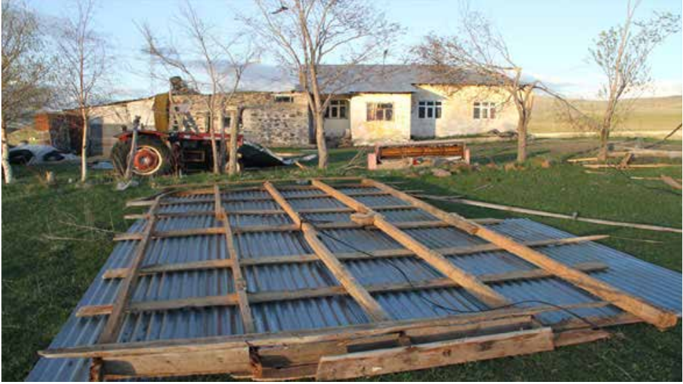
Hortumdan hasar gören yapılar
