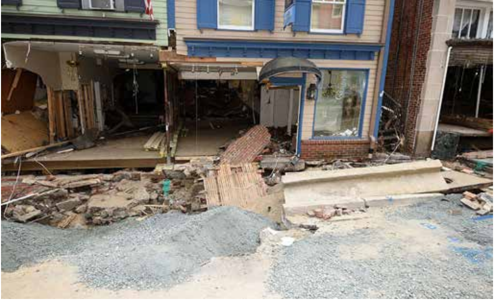
Maryland, Ellicott şehrinin ana caddesinde sel hasarlarından bir görünüm
