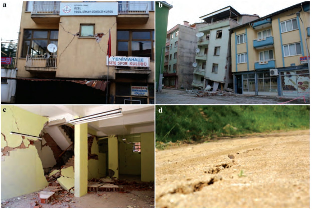
Şekil 5. Simav depremi sonrası meydana gelen yapısal hasarlar (a, b, c) ve yüzey çatlakları (d) Figure 5. Structural damages after Simav earthquake (a, b, c) and surface rupture (d)
