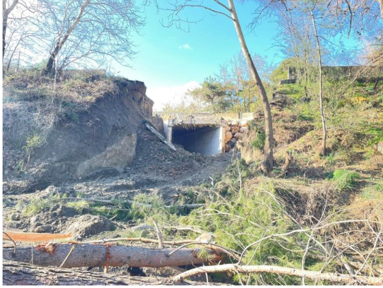
Şekil. Yıkılan yol (Açı: Güneyden Kuzeye)
