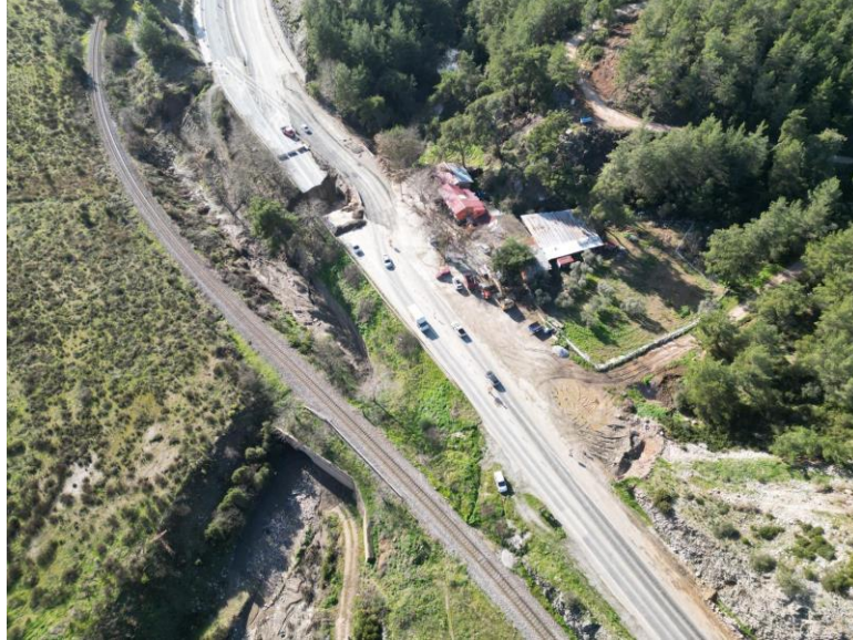
Şekil. Yıkılan Yol ve TCDD Alt Geçidi, Sel Güzergahı
