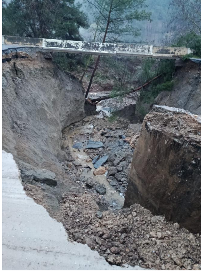
Şekil. Yıkılan yol (Açı: Kuzeyden Güneye)
