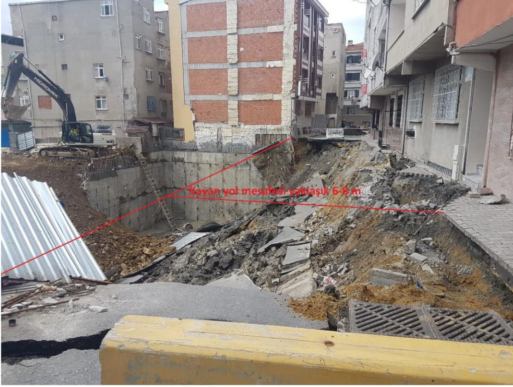
Şekil 2: Esenler Kemer mahallesi 945. Sokak yolu kayma görüntüsü
