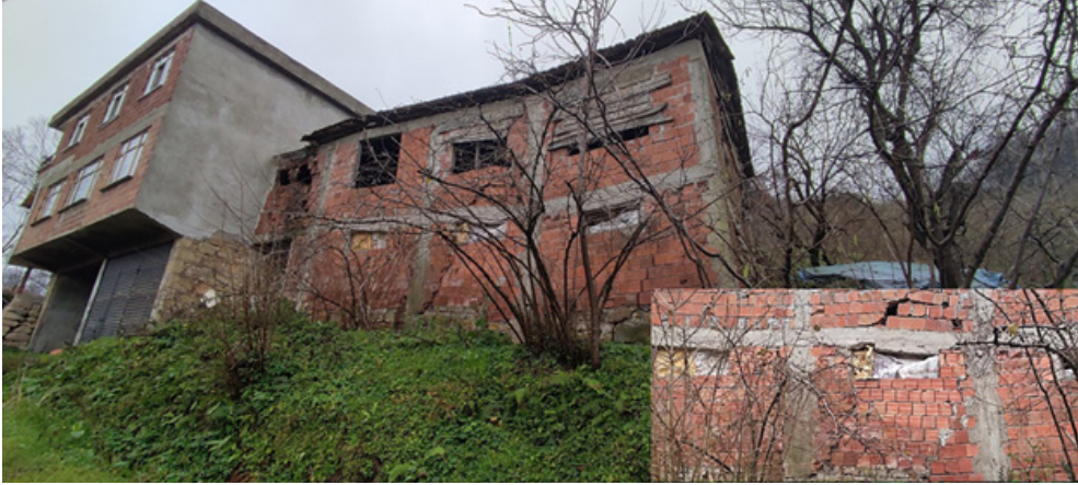
Şekil 4.7. Şenyurt mahallesinde ruhsat sahası içerisinde bir yapıda oturmaldan dolayı meydana gelen yapısal hasarlar.
