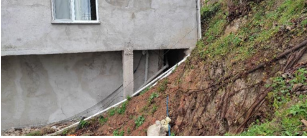
Şekil 4.6. Ayrışmış andezit – killi zemin üzerine inşa edilen konutta meydana gelen hasarlar.
