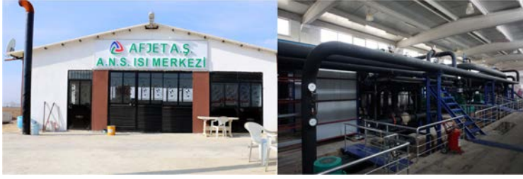
Şekil 7. Afyon şehir ısıtması (AFJET'ten alınmıştır)
