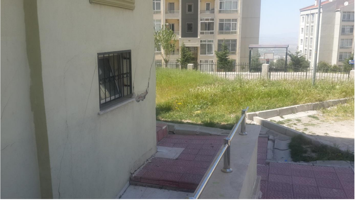
Şekil-3 TOKİ İlköğretim Okulunda çatlaklar
