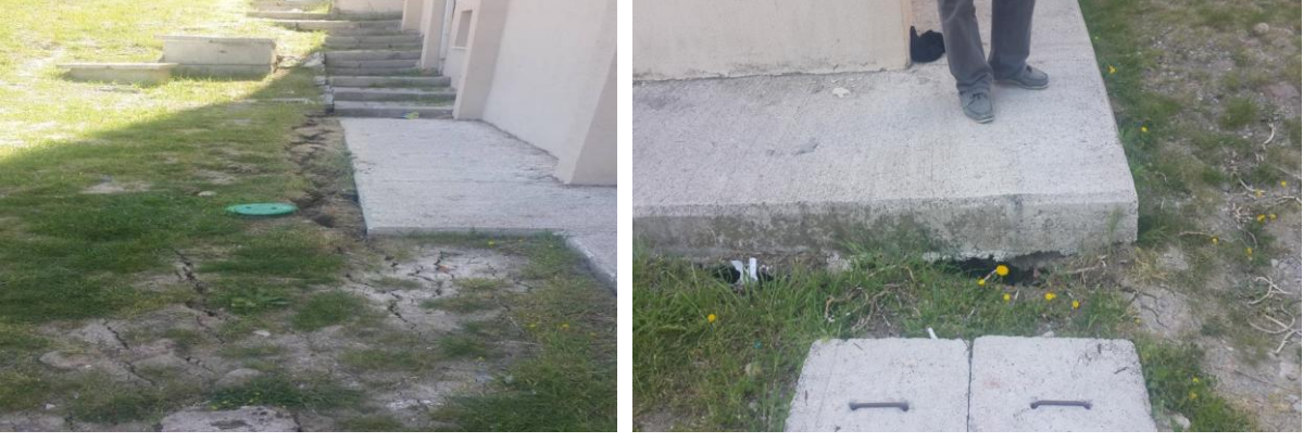
Şekil-2 TOKİ Binalarında zeminde çatlaklar ve bina temelinde açılmalar.
