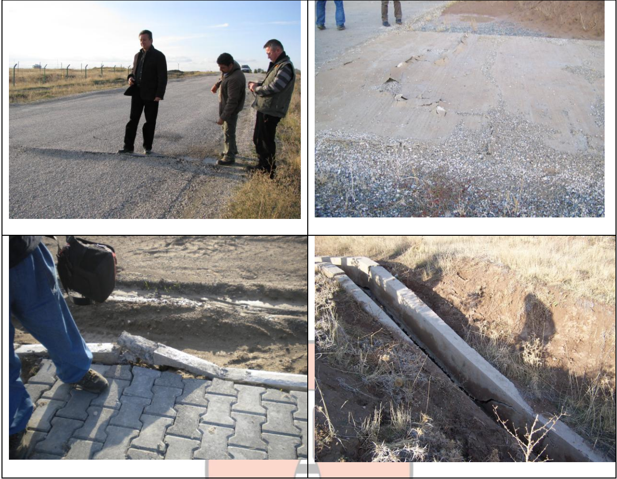
Şekil 16. 23 Ekim 2011 Van depremi sırasında gelişmiş olan antiklinal geometrili sıkışma yapıları. Sol üst fotoğraf asfalt yola dik gelişmiş sırt şeklindeki sıkışmayı, sağ üst fotoğraf eski hastane temelinde gelişmiş yanıl sıçramalı antiklinal geometrili deformasyonu, sol alt fotoğraf yol kenarındaki kaldırımda sıkışma nedeniyle gelişen kabarma ve kırılmayı, sağ alt fotoğraf aynı lokasyonda, yol kenarındaki kanalın alt ve üst kesiminde gelişen kırılmaları göstermektedir.
